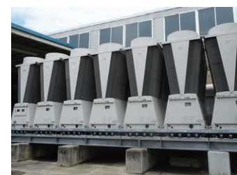
空調機用の電気式チラー
